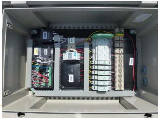
IMG 5. Gabinete DATA LOGGER armado
